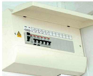
Slika 3 – Električna razdjelna ploča s osiguračima (izvor: Web)
