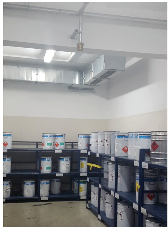
Slika 7 – Skladište boja i lakova s ventilacijom i sustavom Novec 1230 (izvor: AD Plastik)
