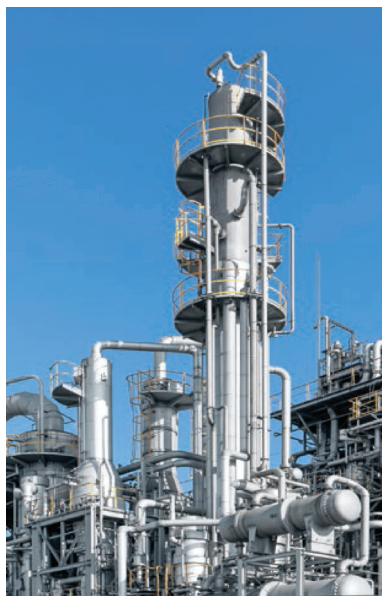
Slika 2 – Apsorpcijska kolona s trietilen-glikolom
