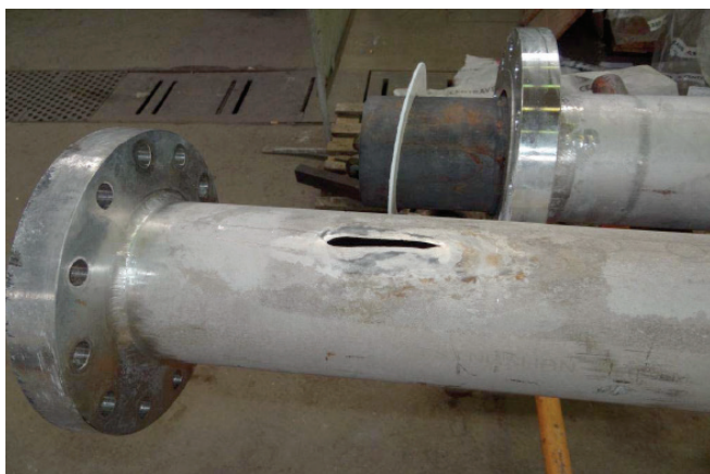
Slika 3 – Oštećenje materijala cijevnog reaktora uslijed korozivnog djelovanja smjese amonijeva sulfata i amonijeva bisulfita
